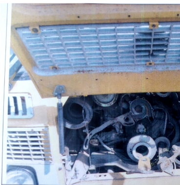
Фото 6 . состояние системы охлаждения и навесного оборудования.
